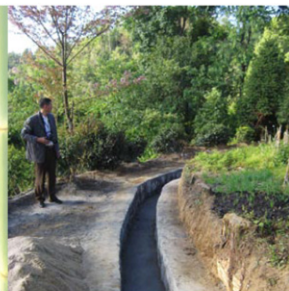
已建成的其中一條防洪溝，對白沙場一社抵禦洪災及泥石流發揮了一定作用。
